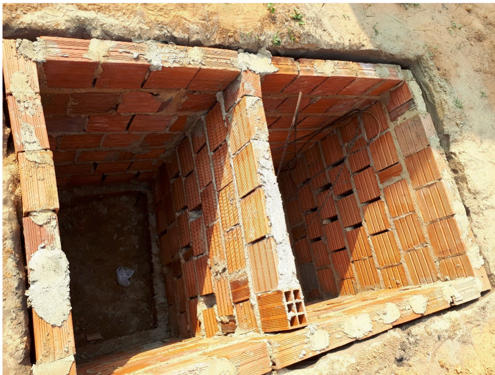
Figura 37: Fossa tipicamente construída em imóveis da região, sendo construída em Vila Nova dos Martírios.
