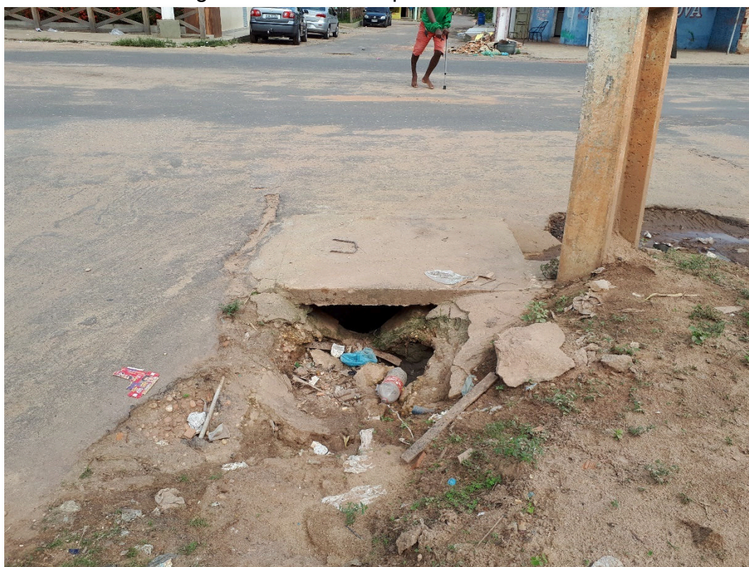
Figura 44: Bueiro simples semiobstruído.
